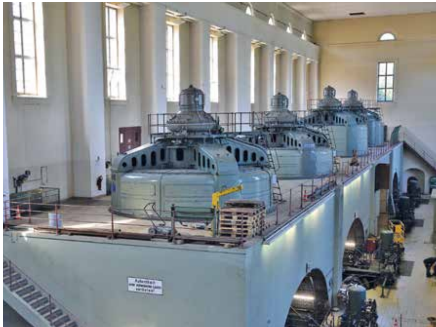
Auch der Blick in die Maschinenhalle (links) war am Tag der offenen Türe möglich
